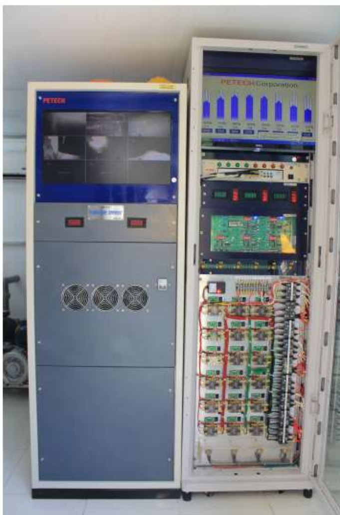
Hệ thống RMS điều khiển hoàn toàn tự động
