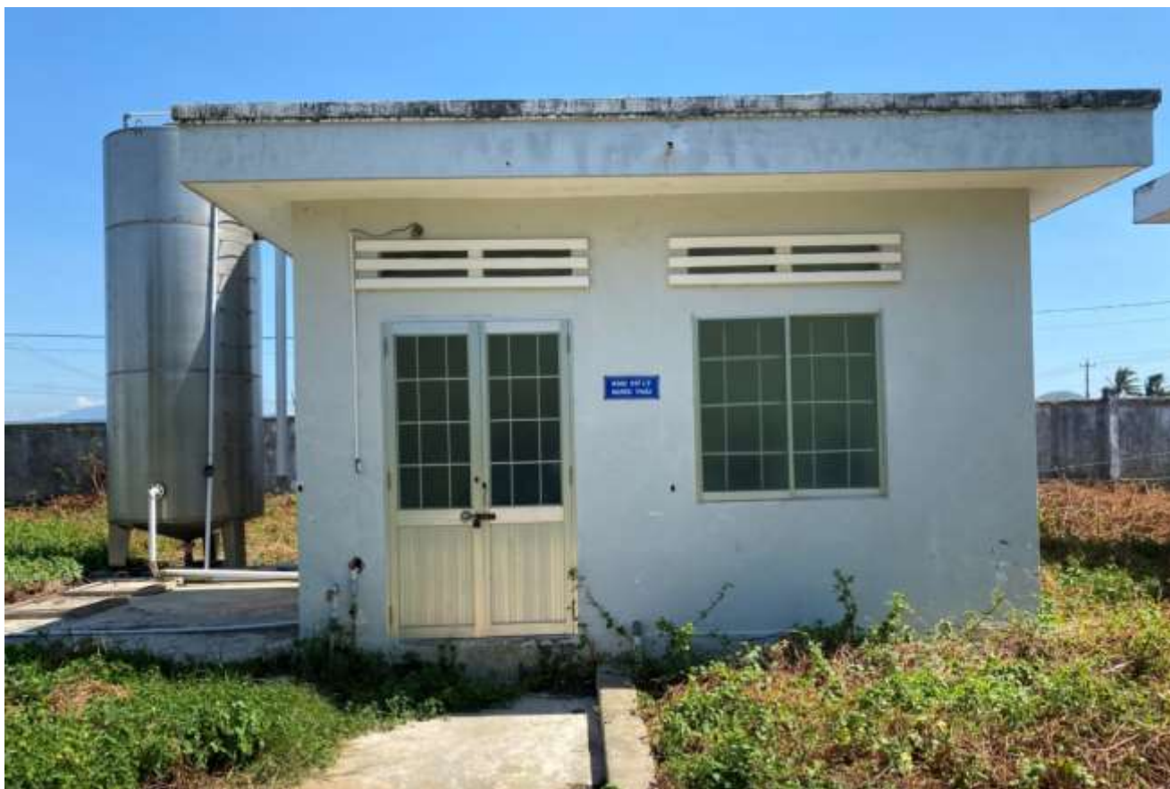
Hình 4. 3. Hiện trạng hệ thống xử lý nước thải 50 m 3 /ngày.đêm của dự án + Thông số kỹ thuật của hệ thống xử lý nước thải 50 m 3 /ngày.đêm
